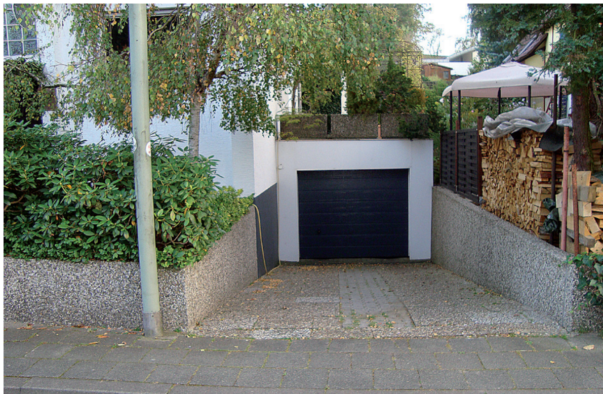
Abb. 17: Abschüssige Garageneinfahrt, an der das Wasser ungebremst in die Garage fließen kann
