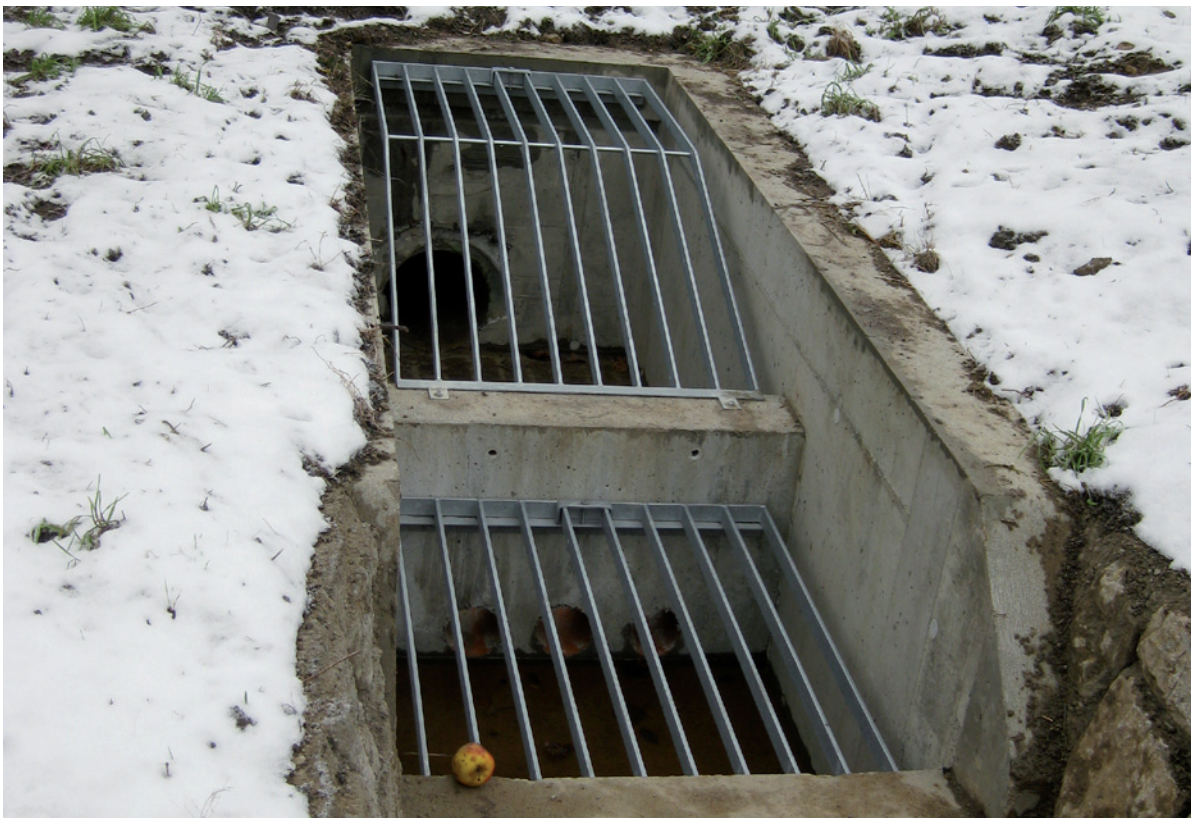
Abb. 32: Räumlicher Rechen am Einlauf zu einer Verrohrung
